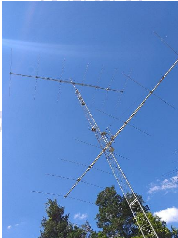
Imagem: Antenas de 10 metros 7 sobre 7 empilhadas, Torre de 30 metros de altura, auto-elevada
